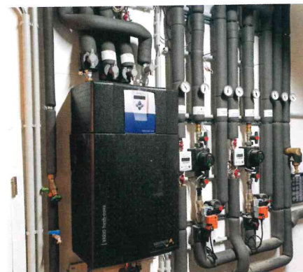
Zur neuen Heizanlage gehört auch ein hydraulischer Durchlauferhitzer VARIO fresh-nova (schwarzes Gerät). Er nutzt die Wärme des Heizspeichers, um frisches Trinkwasser zu erhitzen. Dabei sind Heizkreis und Trinkwasser strikt getrennt.
