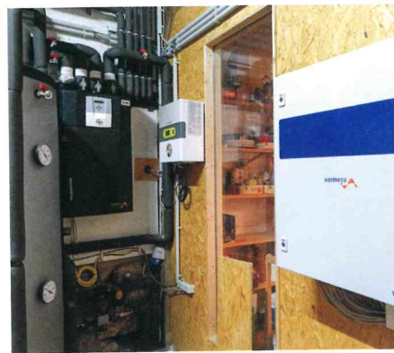
Die eXm (li.) hebt die von der Wärmepumpe gelieferte Temperatur auf zirka 65 °C an. Der Systemregler (re.) überwacht alle Quellen und optimiert die Heizkreise.
