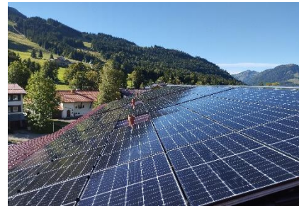
PV-Anlage Panoramahotel Oberjoch Bildquellen: Adler Solar GmbH
